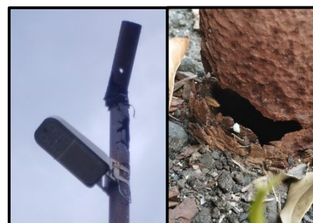
ポールの劣化事例
