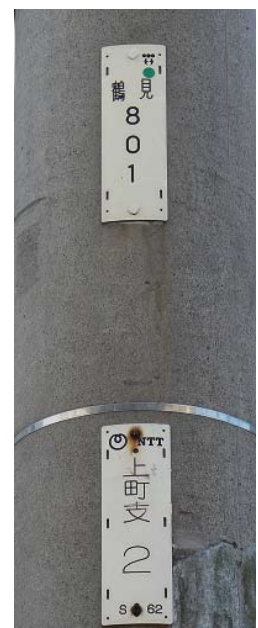
東京電力も使用しているNTT柱
